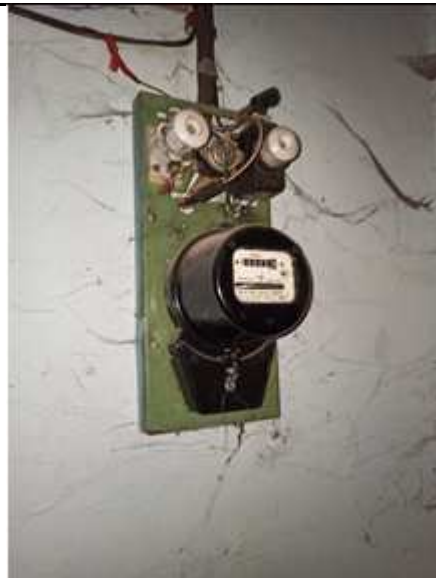
Фото №14 Электросчетчик в помещении
