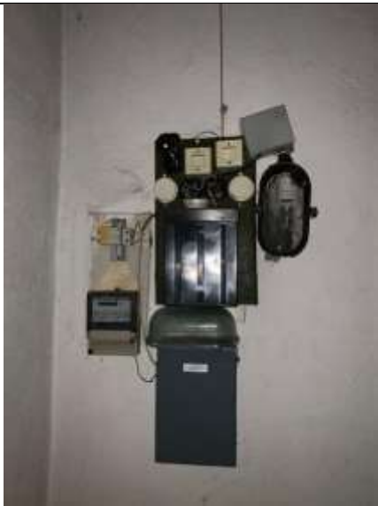
Фото №15. Внутренний вид ч.п. 2. Электрооборудование
